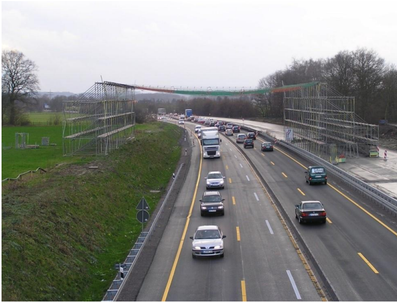
Abbildung 16: Stahlrohrschutzkonstruktion mit Netz über einer Autobahn
