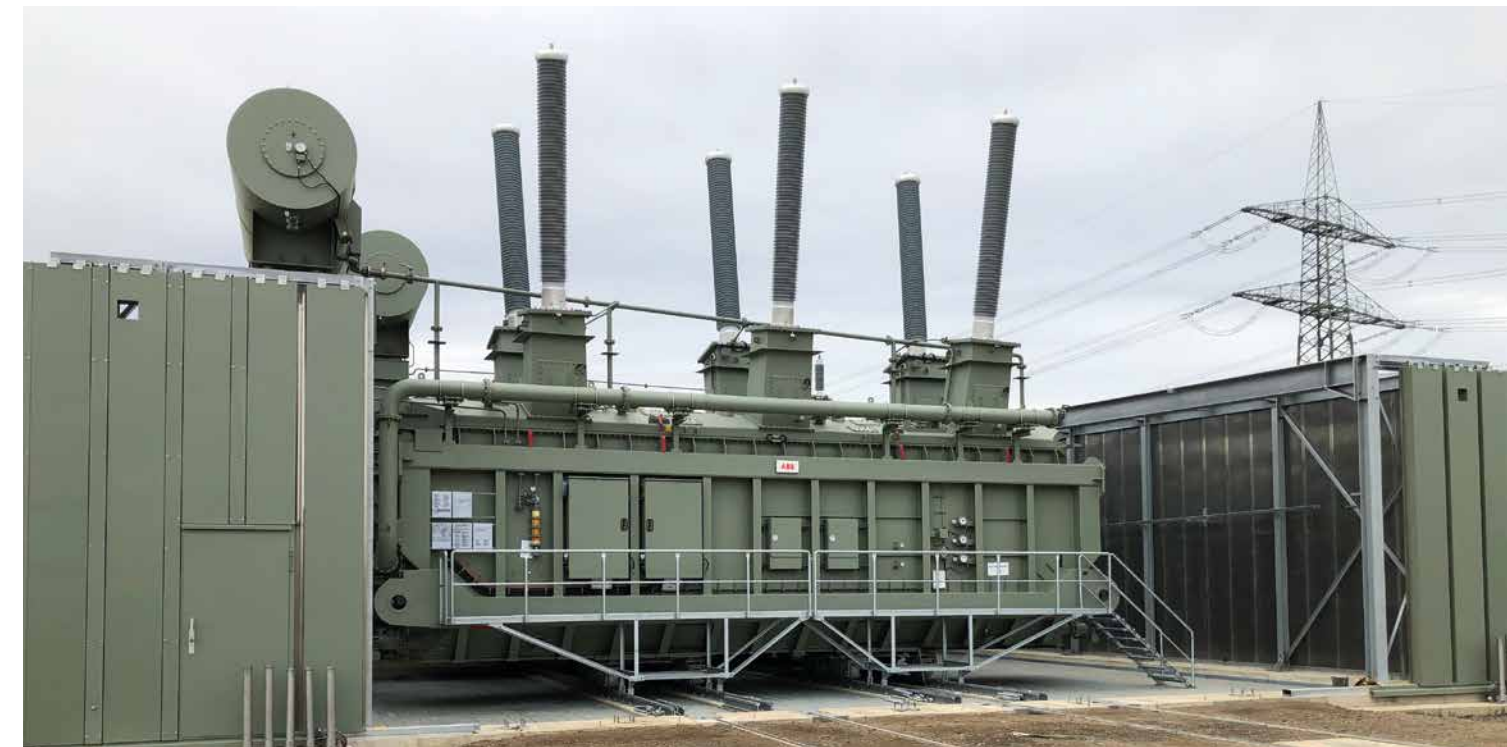
Mithilfe des Phasenschiebertransformators lässt sich der Lastfluss steuern
