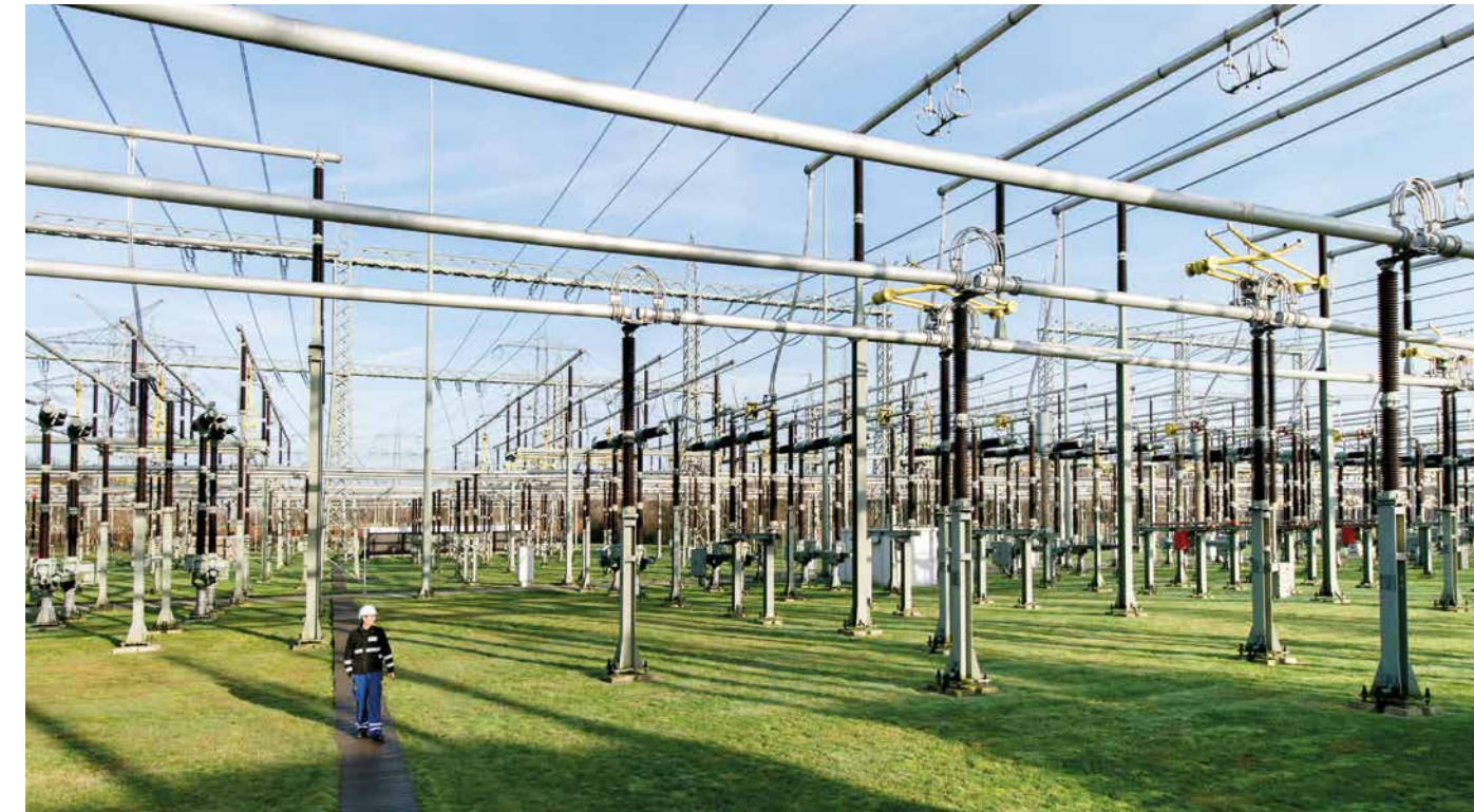
Für die Errichtung von Schalt- und Umspannanlagen werden bereits sehr früh geeignete Standorte geprüft
