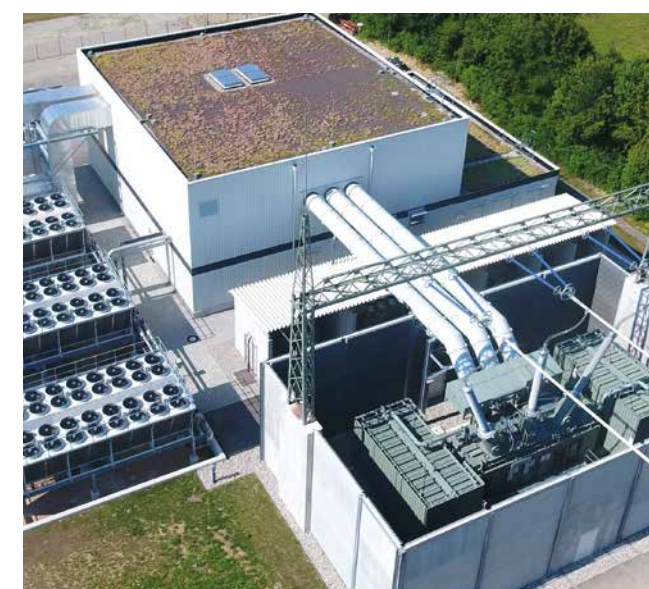
RPSA übernehmen durch ihre schnelle und stufenlose Blindleistungsbereitstellung eine wichtige Rolle bei der dynamischen Spannungshaltung
