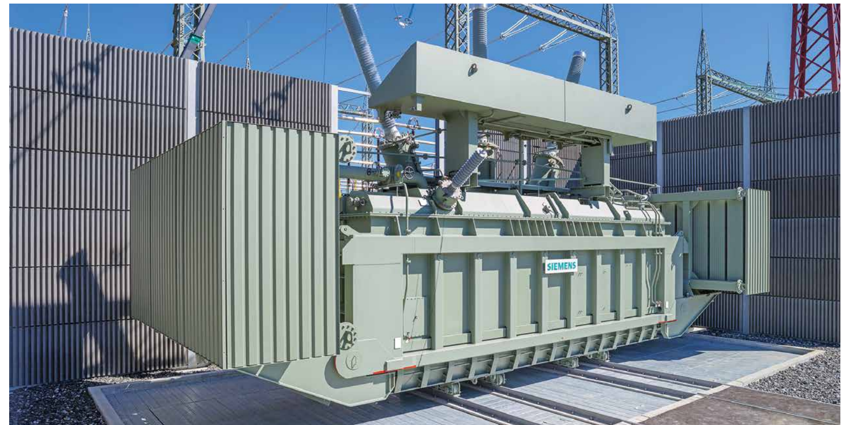
Drosseln kommen dann zum Einsatz, wenn die Spannung zu hoch ist. Mit modernen, regelbaren Drosseln lässt sich die Spannung stufenweise senken.
