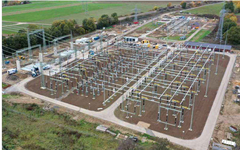
Drohenaufnahme einer Schaltanlage
