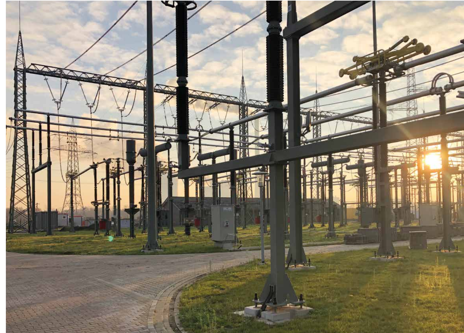
Leitungsfeld einer Freiluftschaltanlage
