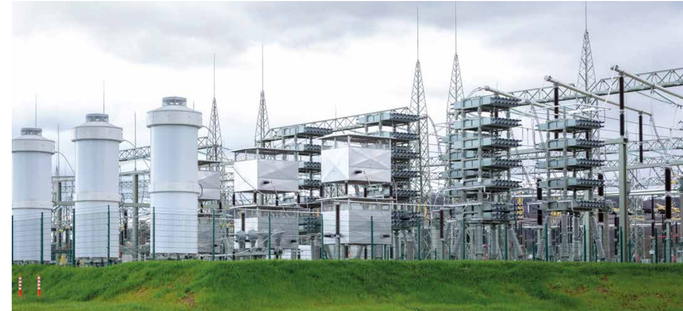
MSCDN-Anlagen stabilisieren die Spannung, indem sie diese bei Bedarf anheben
